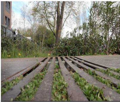
Şekil 25; İTÜ Ayazağa Yerleşkesi yağmur bahçesi için kullanılan ızgara sistemi(22)
